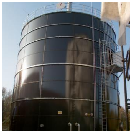
Kläranlage Rietberg Niederdruckgasspeicher 50 mbar Volumen: 1.000 m 3
