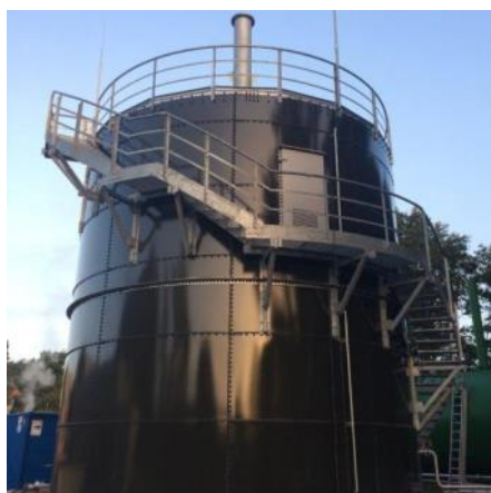
Kläranlage Trittau Niederdruckgasspeicher 30 mbar Volumen: 250 m 3
