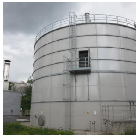
Kläranlage Wiesbaden-Biebrich Niederdruckgasspeicher 45 mbar Volumen: 2.500 m 3
