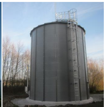
Kläranlage Halle Druckloser Speicher Volumen: 384 m 3
