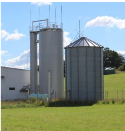
Kläranlage Vestenbergsgreuth Druckloser Speicher Volumen: 200 m 3
