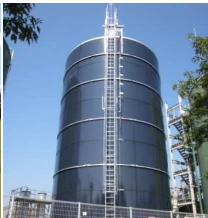
Kläranlage Nantan (Japan) Druckloser Speicher Volumen: 500 m 3
